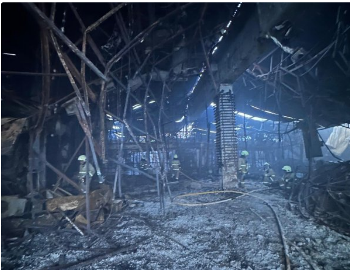
Glodok Plaza yang Hangus Terbakar
